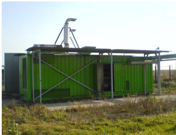
Kontenery agregatów kogeneracyjnych
