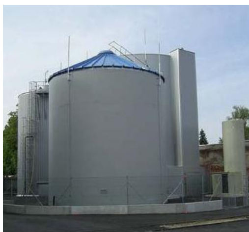
Rys. 17 Biogazownia przy mleczarni w Wels źródło:
