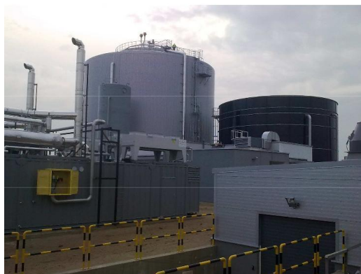
Rys. 12. Instalacja do beztlenowego oczyszczania ścieków w SM Mlekovita
