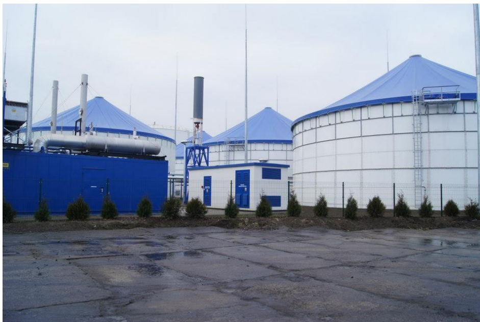
Rys. 10. Biogazownia w OSM Czarnków
