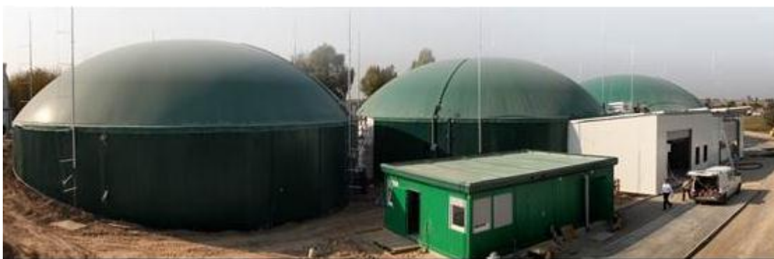
Rys. 11. Biogazownia w Siedliszkach
