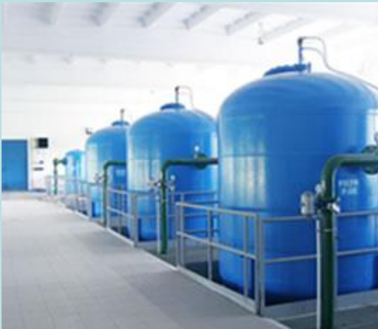
Filtry pospieszne zamknięte w układzie do odżelaziania wód podziemnych - Węgrów
