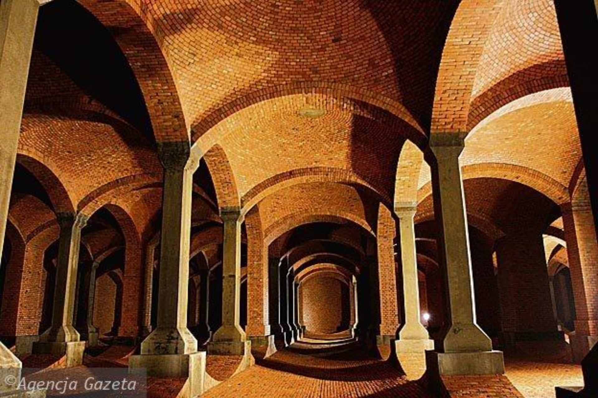
Zbiornik wody pitnej Stoki – Wodociągi Łódzkie
