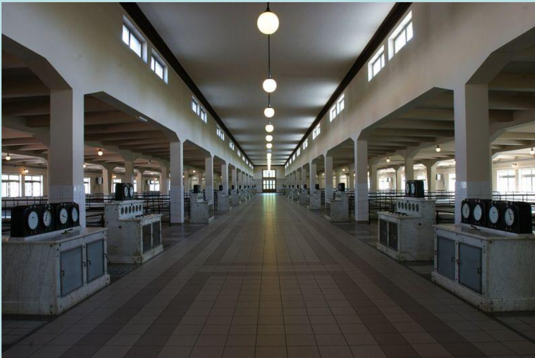
Hala filtrów pospiesznych - Warszawa
