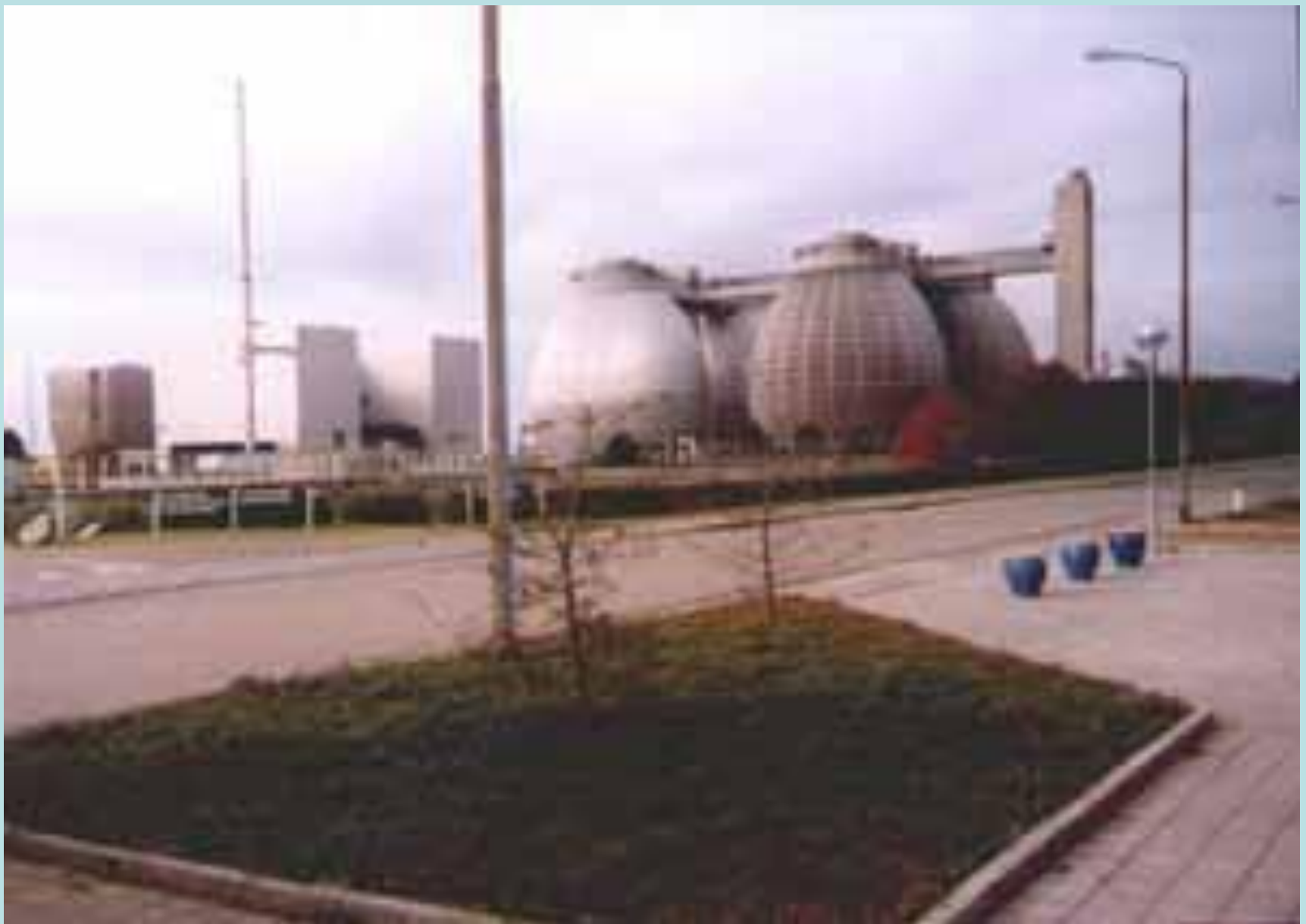
Komory fermentacyjne połączone ze spalarnią osadu, Avedore koło Kopenhagi
