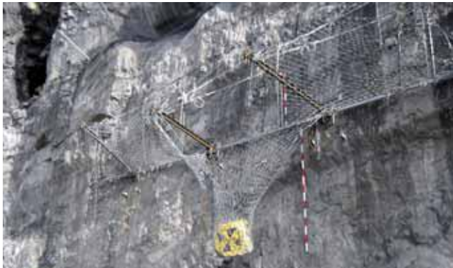
Bariera RXI-500 o nośności dynamicznej 5000 kJ, po zatrzymaniu bloku skalnego o masie 16 000 kg, spadającego pionowo z wysokości 32 m!
