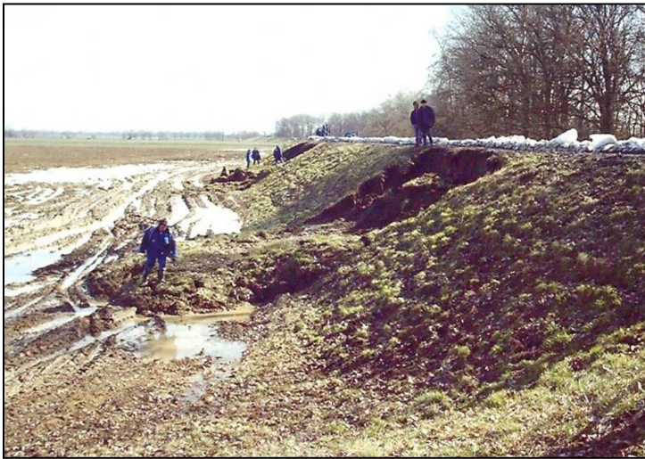
Uszkodzony wał przeciwpowodziowy z powodu przesiąkania.
