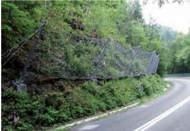
Bariera RXI-025 chroniąca drogę nr 971 przed spadającymi obrywami skalnymi, Żegiestów k. Nowego Sącza
