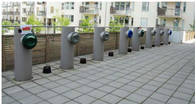
Pneumatyczny system zbiórki odpadów
